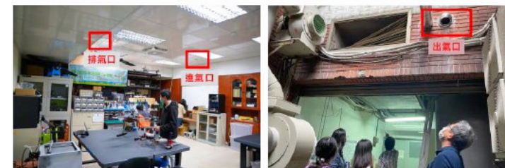
▲圖 (左)地下室實際照片 (右)全熱交換機出風口位置
